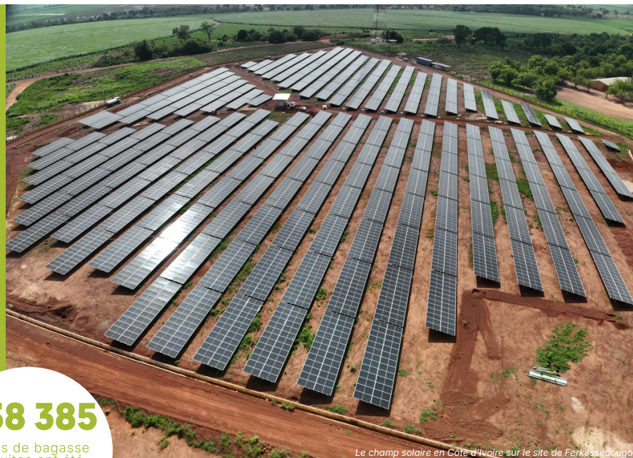
Le champ solaire en Côte d'Ivoire sur le site de Ferkessedougou
